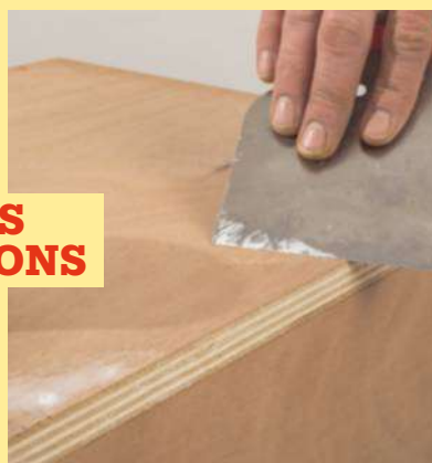
23 Avant de poncer et de peindre les surfaces en contreplaqué, rebouchez les fissures éventuelles et les emplacements des têtes de vis avec un enduit gras.
