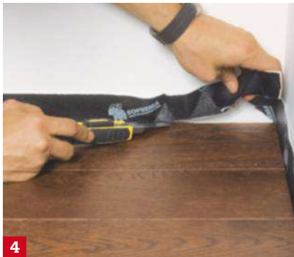
4 La dernière lame en place, coupez la sous-couche qui dépasse à la hauteur du parquet. Laissez sécher, puis posez les plinthes.
