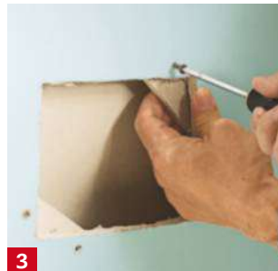
3 Découpez deux supports dans une plaque de plâtre et vissez-les derrière la paroi pour former des appuis dans les angles.
