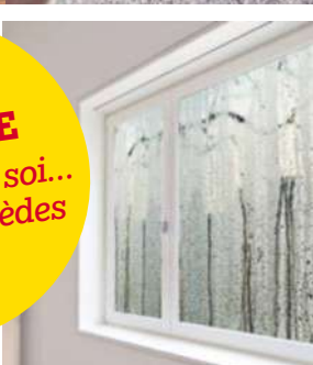
Humidité et moisissure Expert
