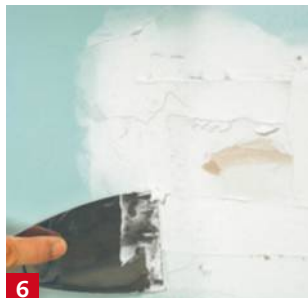
6 Appliquez largement une couche d'enduit en n'hésitant pas à déborder sur les côtés du raccord.
