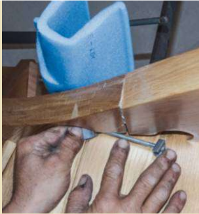
14 La liaison entre les deux limons est bridée à l'aide de vis de rappel qui relient deux étriers placés dans des chapelles (entailles pratiquées pour recevoir la tête de vis et les étriers).
