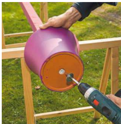
4/ À travers le trou du pot, enfoncez un tirefond ou une grosse vis au centre du pied du poteau, en intercalant une rondelle en Inox. Cette fixation vise surtout à garantir le centrage.
