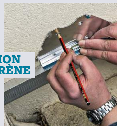
13 La sirène extérieure est également alimentée par des piles (autonomie de 2 ans). Une plaque métallique permet de la fixer solidement sur l'un des murs.
