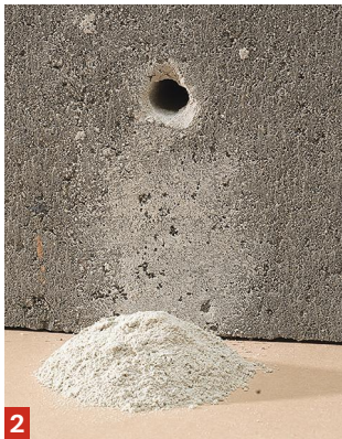
2 La poussière est fine, de couleur blanche ou grise et elle ruisselle : il s'agit d'un mur en béton.
