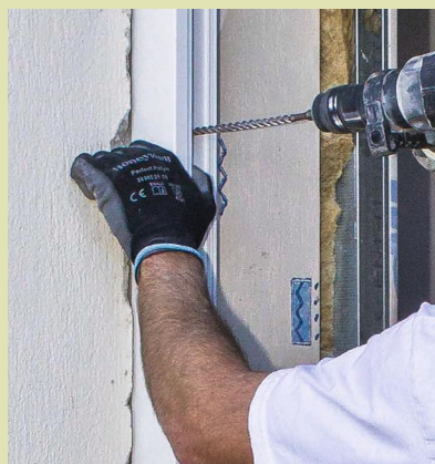
9 Dans chacun des trous, prolongez le perçage dans la maçonnerie à l'aide d'un perforateur équipé d'une mèche à béton (Ø 8 mm) sur 15 cm de profondeur.
