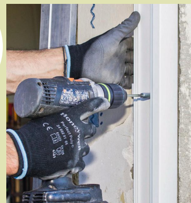
11 À la visseuse équipée d'un embout hexagonal adapté, terminez la fixation du dormant tout en contrôlant régulièrement l'alignement et l'aplomb au niveau à bulles.
