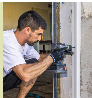
8 Percez trois trous dans l'épaisseur des montants en PVC du dormant, à intervalles réguliers sur la hauteur du cadre, afin de bien répartir les fixations dans la maçonnerie.
