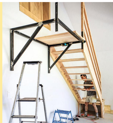
26 Contrairement à l'usage habituel, la mise en place des marches dans les limons s'effectue ici en partant du haut: le poteau supérieur est soutenu par la console pendant l'opération.
