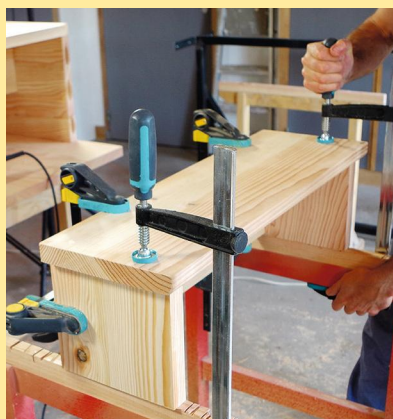
27 La dernière marche se pose sur le palier devant la porte du grenier. Construite comme un banc, avec deux côtés supportant la marche et une contremarche de contreventement.
