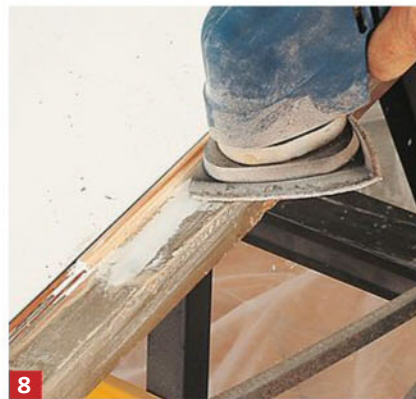
8 Poncez légèrement avec une ponceuse munie d'un abrasif très fin (200). Pour les creux de la moulure, pliez un papier abrasif (150) sur une cale mince.
