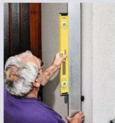
10 L'alignement (gauche-droite) des gonds étant satisfaisant, contrôlez leur alignement avant-arrière en posant la règle sur les gonds. Ajustez-les en les enfonçant plus ou moins.
