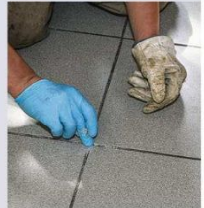
15 Une fois le traitement achevé et les tubes sectionnés à leur base, les trous sont rebouchés à l'aide d'un mortier pour joints de teinte équivalente à celle du joint d'origine.
