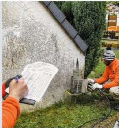
2 La société procède aux tests qui permettent de calculer la résistance du sol. Réalisés à intervalles réguliers, ils déterminent les niveaux d'injection pour chaque percement.
