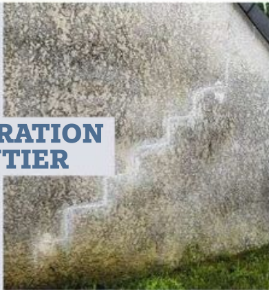
1 Causées par le mouvement des fondations, les fissures en escalier suivent les joints des blocs de maçonnerie.
