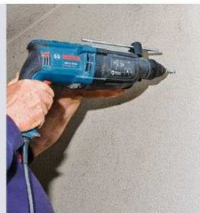
8 Une fois vos repères tracés, percez le mur à l'aide d'un perforateur en mode percussion pour faciliter le travail.
