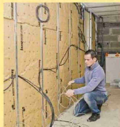
24 Suivant votre plan électrique, tirez vos câbles (ici sans gaine) en leur permettant de cheminer entre les montants métalliques. Séparez le courant fort du courant faible.
