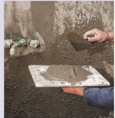
10 D'un geste sec et précis, projetez le mortier à la truelle, déposé en tas sur une taloche. L'application s'effectue de bas en haut sur quelques millimètres d'épaisseur.
