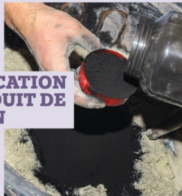
12 La veille de l'intervention, teintez la pâte de base en versant lentement le pigment. La quantité de poudre ne doit pas excéder 15 % du volume de la chaux.
